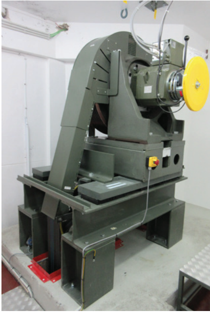
Figura 6. Máquina do novo elevador, Schindler.
