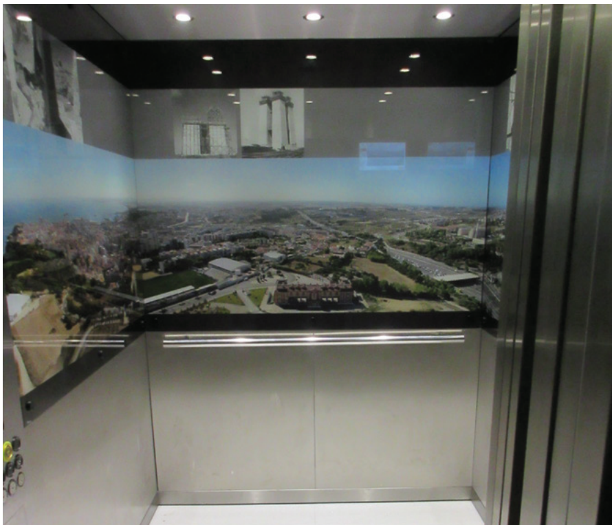
Figura 7. Cabine do novo elevador.
